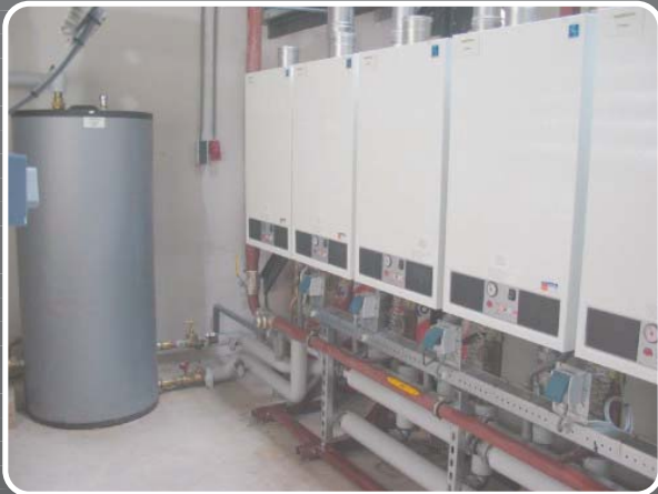
5 X 100 kW Boylerli Kaskad Sistem Uygulaması
