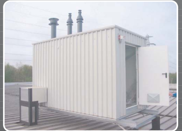
Çatı Üstü Kaskad Sistem Uygulaması
