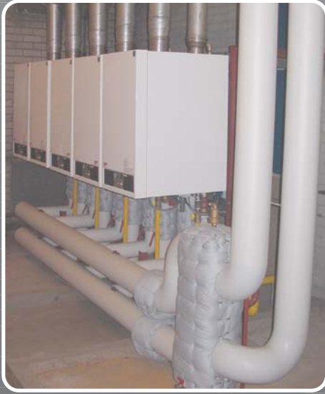
5 X 150 kW Kaskad Sistem Uygulaması
