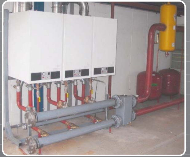
3 X 180 kW Kaskad Sistem Uygulaması
